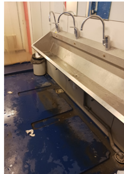
Afbeelding 10. Wastafels in no Assen (14 juni 2023)
