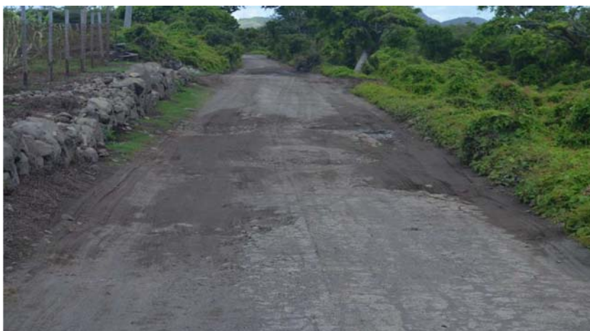
De staat van onderhoud (september jl.) van de Road Behind the Mountain.
